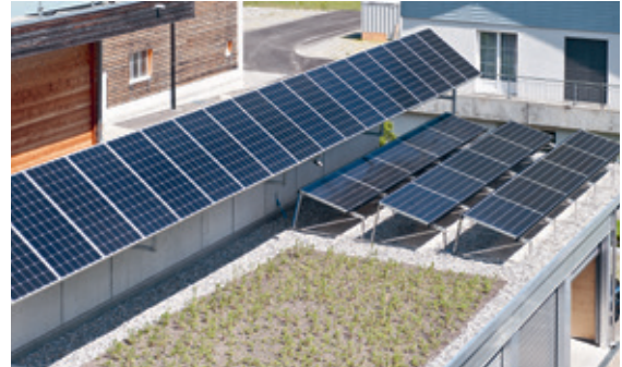
Vorne fixe, hinten sonnengeführte Photovoltaikanlage
